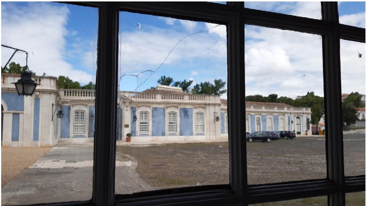
Figura 4: Vidros das janelas exteriores do Palácio Nacional de Queluz quebrados, em abril de 2021, durante ações de limpeza da via pública.
